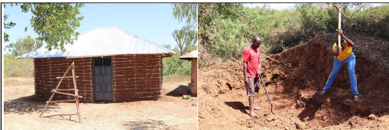
Bondo: Nieuwe hut waar de eigen zonen klei delven voor de afwerking. Aan de hut reeds een gootje. Voor de hut een trap.
